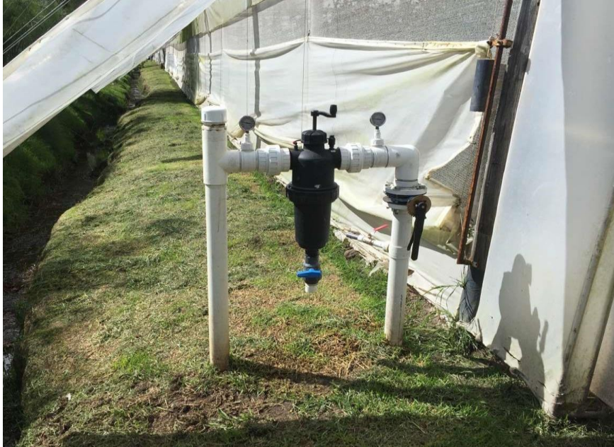
Fig. 3 Filtros de malla semiautomáticos a la entrada de cada bloque
