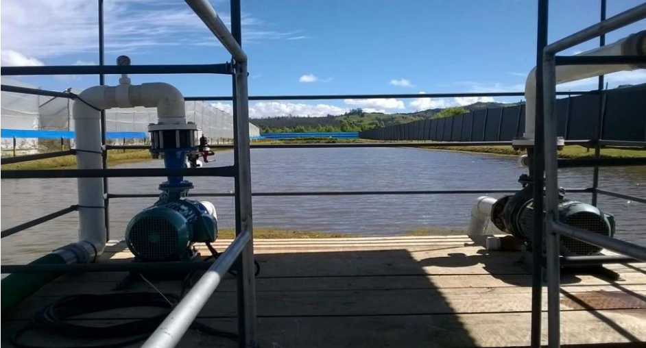
Fig 1. Estación de bombeo sobre balsa flotante
